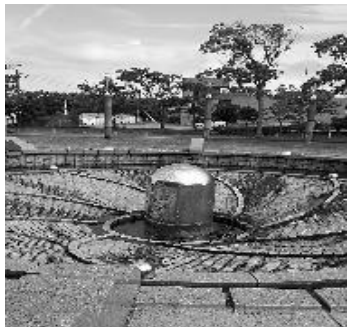
藤代スポーツセンターの壊れたままの噴水
